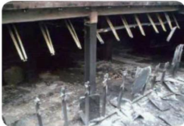
지수판 용접중 하부 우레탄 보온판 화재로 4명 사상
