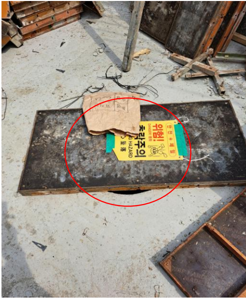
개구부 덮개를 거푸집 유로품 미고정 상태로 사용하여 덮개 탈락으로 떨어짐 위험
