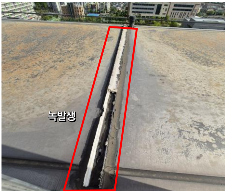
〈보조 몰딩 및 코킹 노후화로 탈락〉
